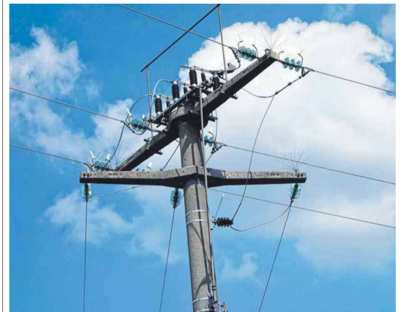
Eine Trennstelle im Stromnetz – wie diese bei Waldburg – musste laut Netze BW geöffnet werden, um Argenbühl am Wochenende wieder mit Strom zu versorgen. FOTO: NETZE BW
